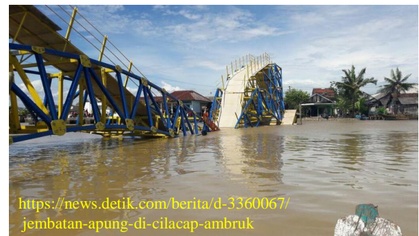
Gambar 1. Jembatan apung di Cilacap ambruk
