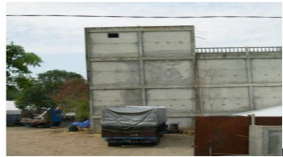
Gambar 4. Bangunan bertingkat yang miring karena penurunan pondasi akibat likuifaksi saat gempa bumi 26 Desember 2004 (Tohari dkk, 2007)
