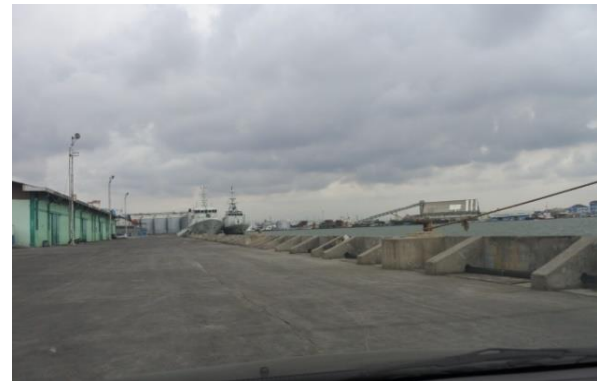
Gambar 1. Dinding beton penahan air laut dipasang akibat terjadi penurunan jetty Pelabuhan Semarang yang disebabkan oleh land subsidence
