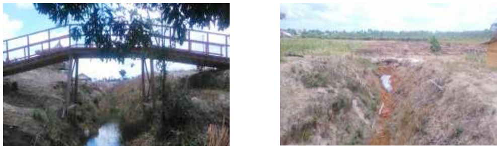
Gambar 2.3. Kondisi saluran yang masih ada air pada musim kemarau dan kekeringan bagian hilir
