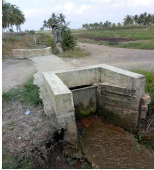
Gambar 2. Pintu air jenis Sorong
