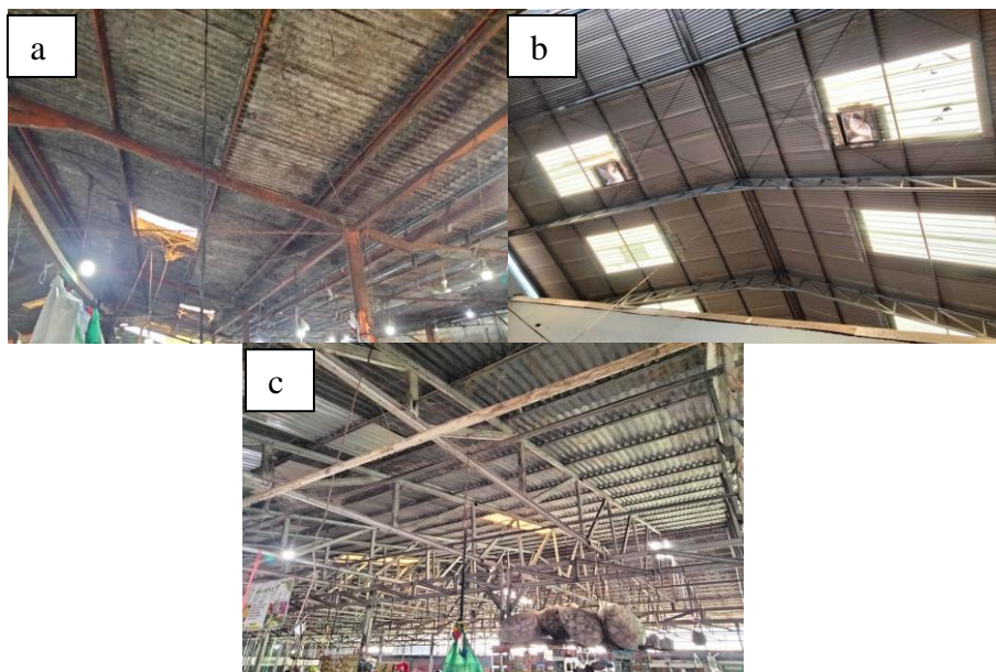
Gambar 1. Kondisi atap pada pasar di Kecamatan Alang-Alang Lebar dan Sukarame: a) atap berbahan seng (Kecamatan Alang-Alang Lebar), b) atap berbahan seng dengan turbin ventilator, dan c) atap seng (Kecamatan Sukarame).
