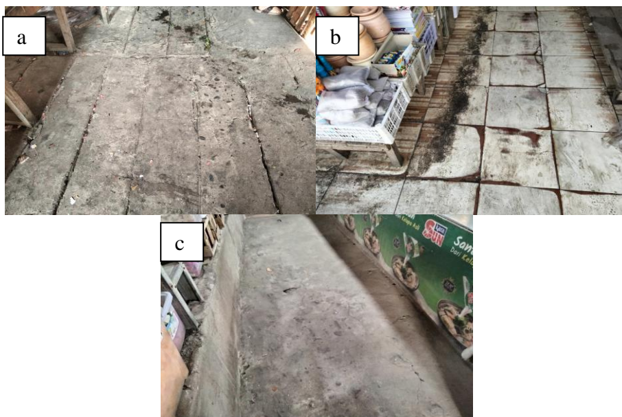
Gambar 3. Kondisi lantai pada pasar di Kecamatan Alang-Alang Lebar dan Sukarame: a) lantai berbahan semen conblok (Kecamatan Alang-Alang Lebar), b) lantai berbahan keramik, dan c) lantai berbahan semen (Kecamatan Sukarame).
