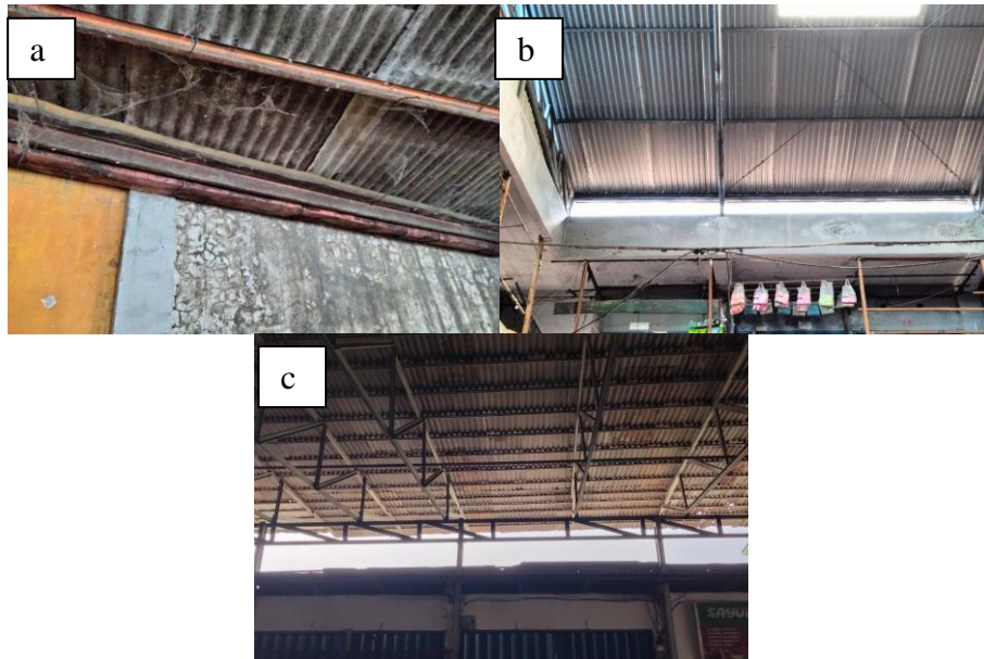
Gambar 2. Kondisi Ventilasi pada pasar di Kecamatan Alang-Alang Lebar dan Sukarame: a) tidak terdapat ventilasi (Kecamatan Alang-Alang Lebar), b) ventilasi berupa celah dari atap dan dinding, dan c) ventilasi juga dari celah atap dan dinding (Kecamatan Sukarame).
